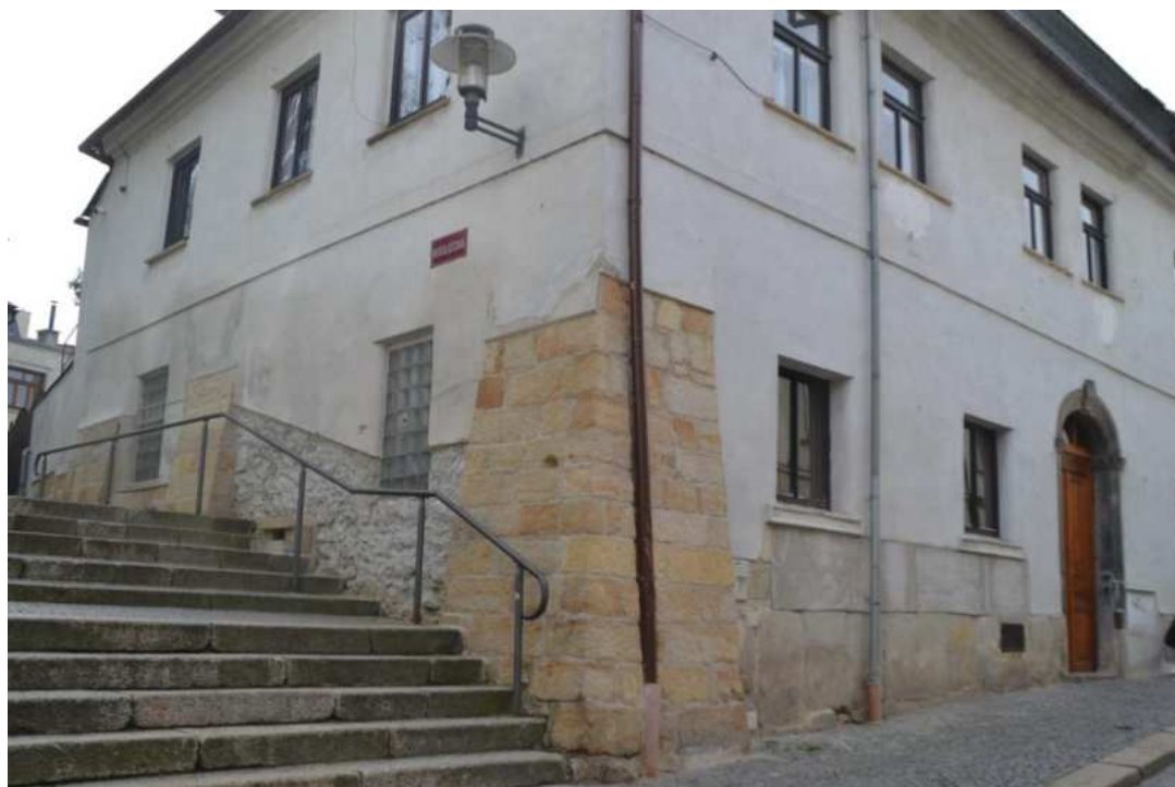
Dům č. p. 98, severozápadní nároží domu, výsledné uplatnění opěráků v režné podobě vytržené od omítaných průčelí je krajně nevhodné, foto IP 2016.
